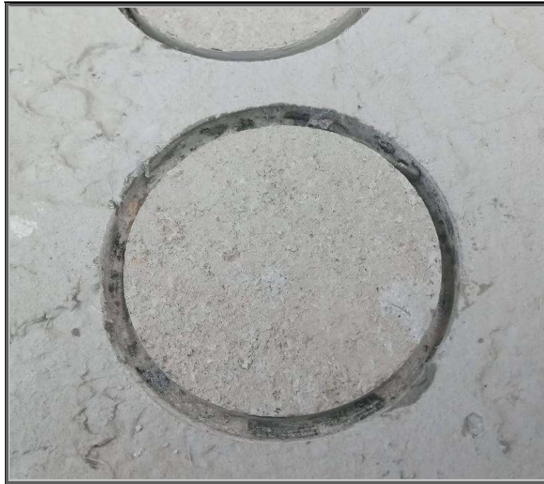
Figura 2 – Detalhe da forma de ruptura na face da placa de concreto – Amostra 01557/2023-001
